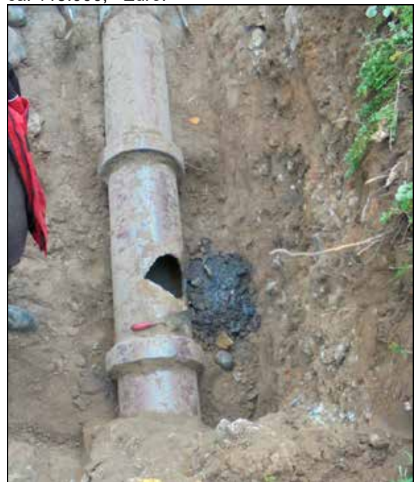
Schaden am Steinzeugrohr „Neckarufer“
