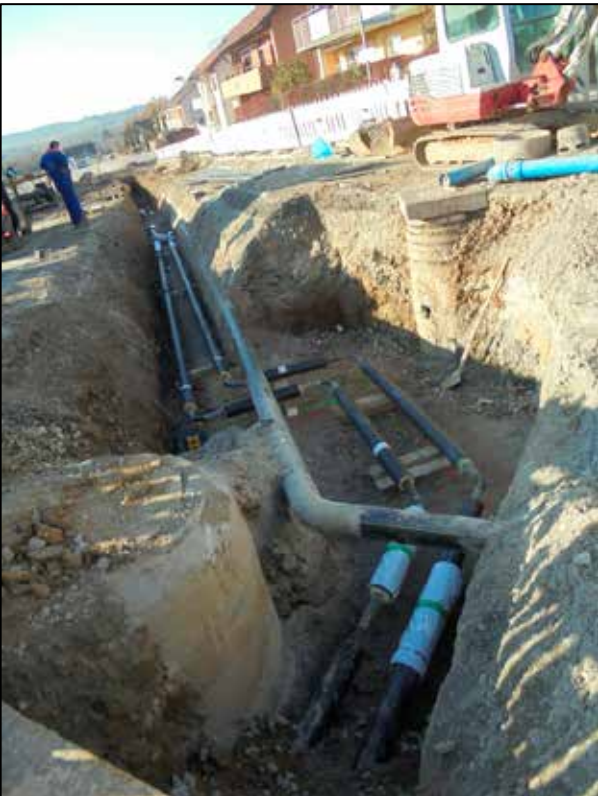
Anschluss Fernwärme „Amorbacher Straße“
