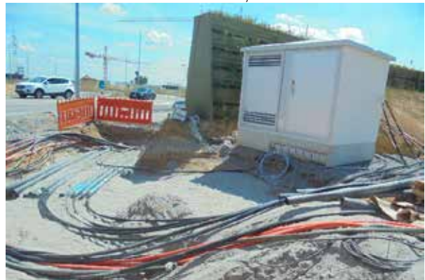
Standort Schaltschrank Versorgungsträger
